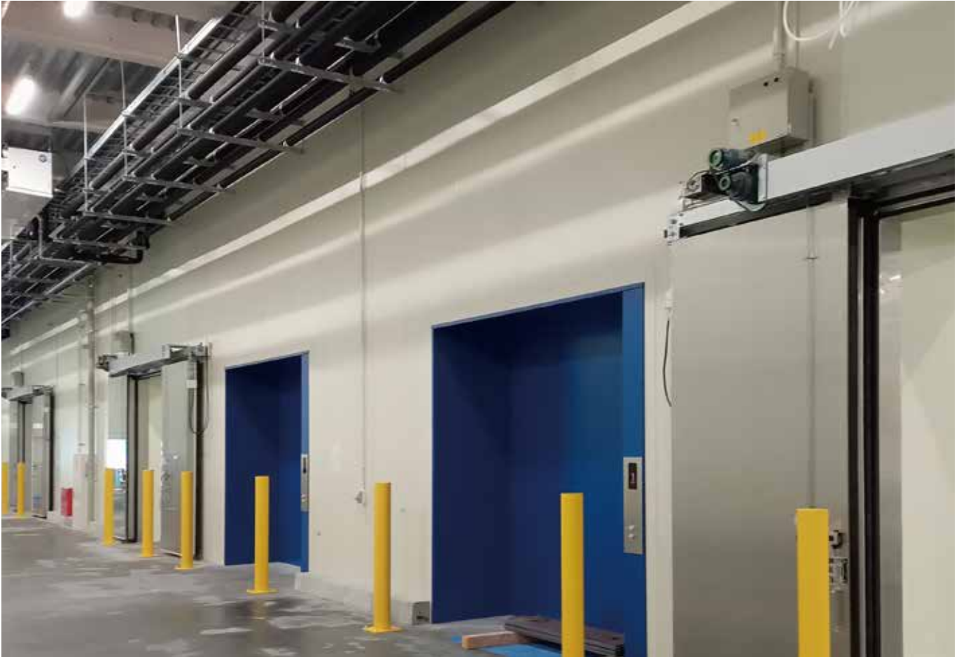
冷凍・冷凍倉庫（明正アイボリー）
