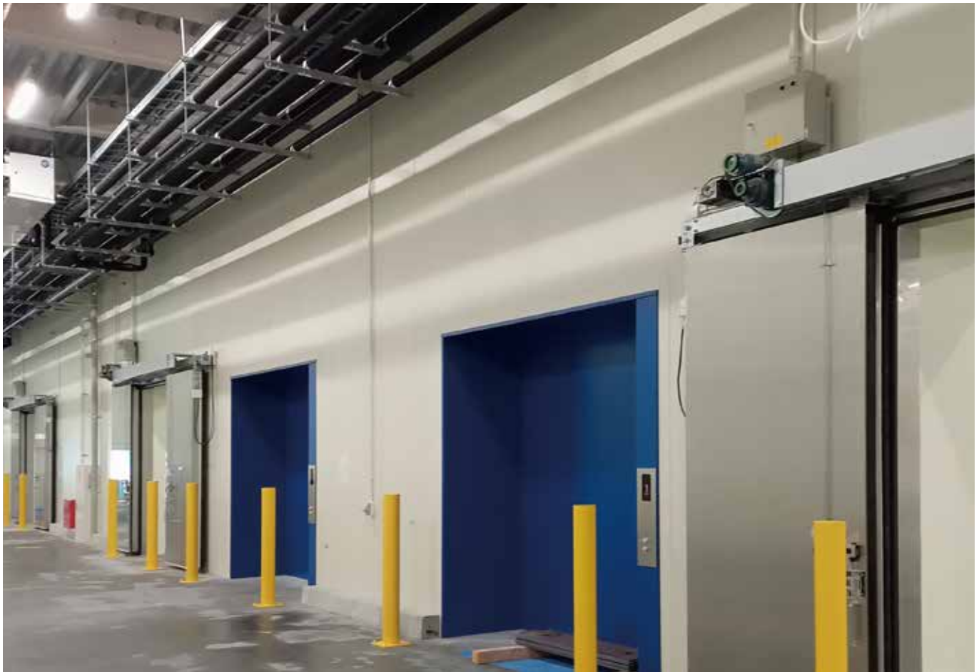
冷凍・冷凍倉庫（明正アイボリー）
